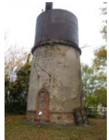
Le château d'eau
